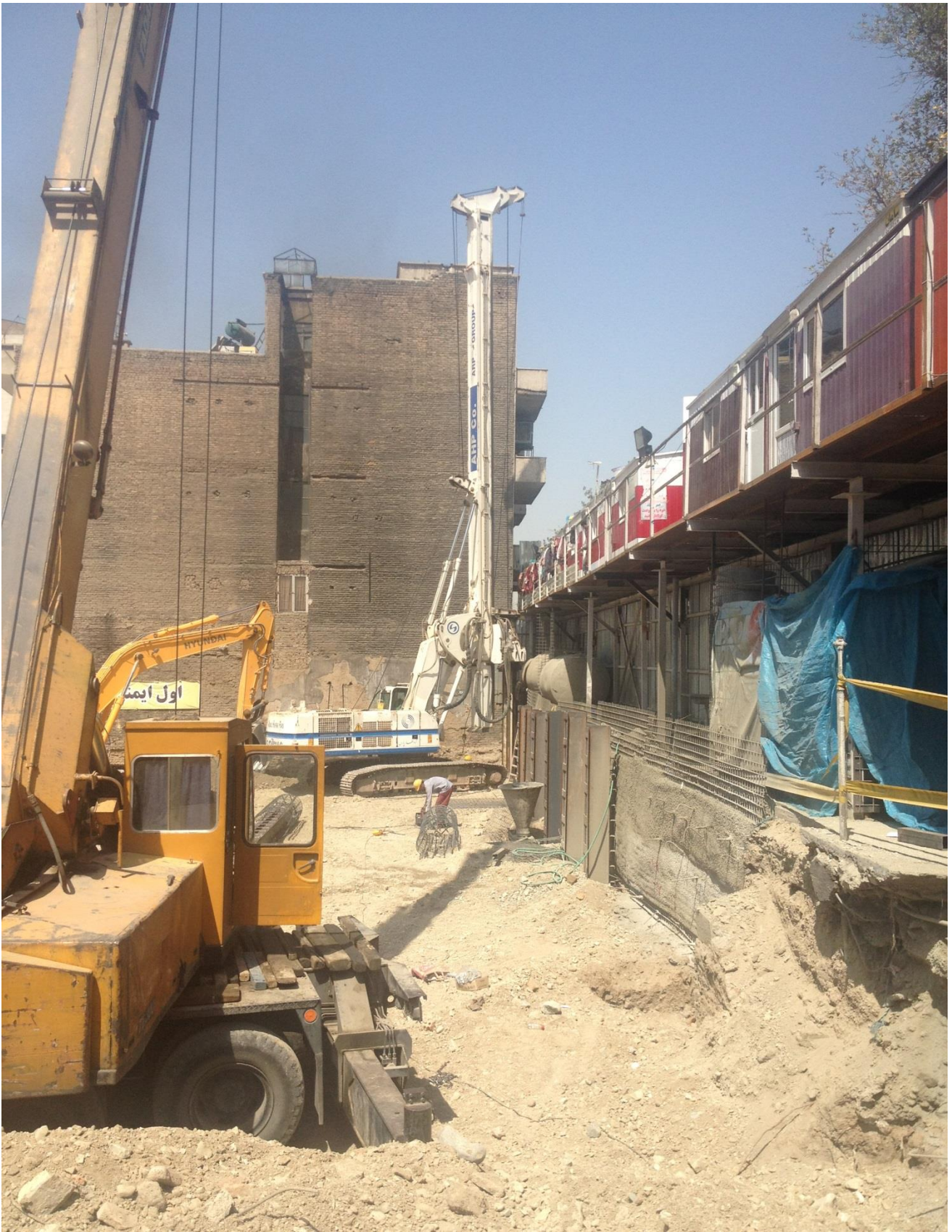
اجرای شمع های پایدار سازی گود (دیوار برلینی) پروژه بانک سینا - خیابان آزادی تهران
